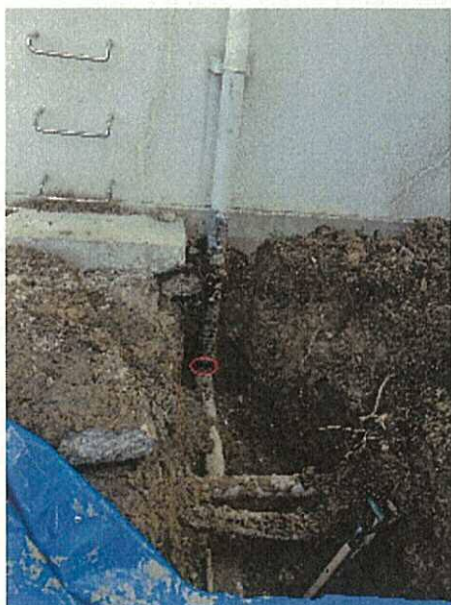
図 2. RI 排水管（赤丸が破断した箇所）
