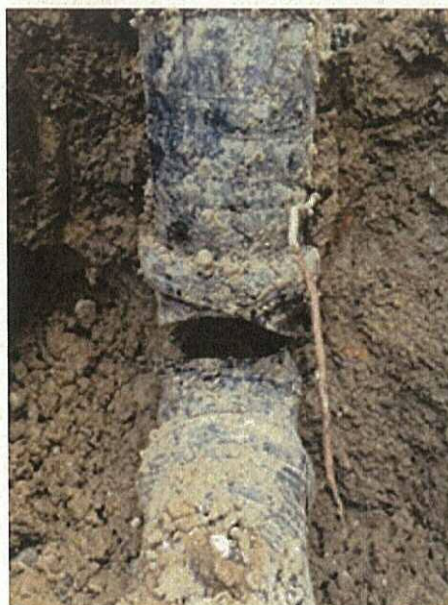
図 3. RI 排水管破断箇所
